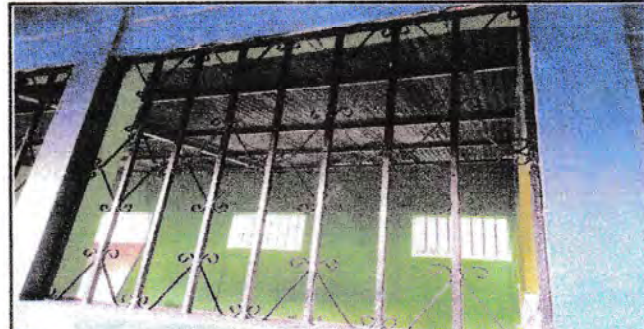
Foto 4: Implementación de 6 ventana de PVC en dos aulas, por motivo que la lámina que cubre el techo del lado Oeste no tiene sobrante y cuando llueve con viento se entra la lluvia.
